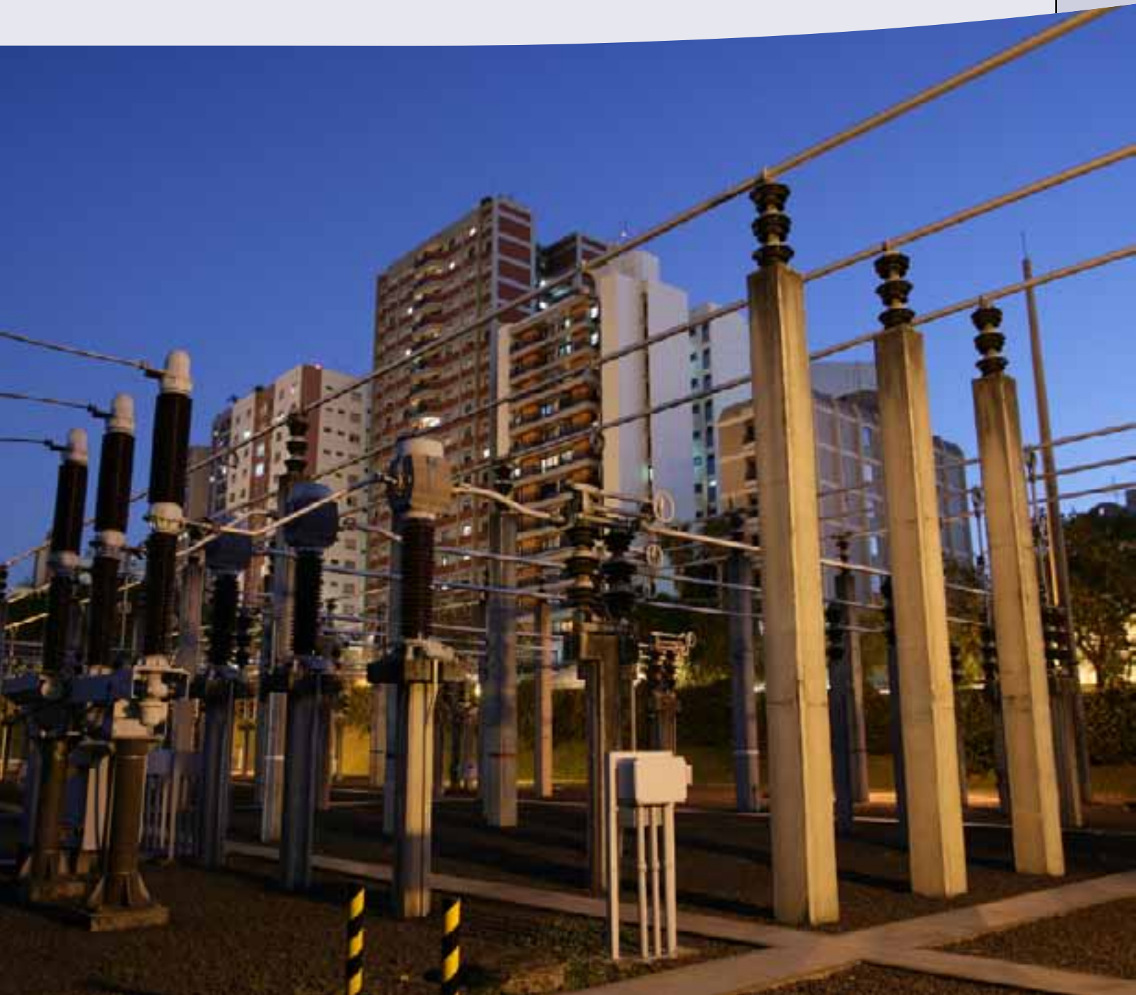
Subestação Centro | Campinas | São Paulo
