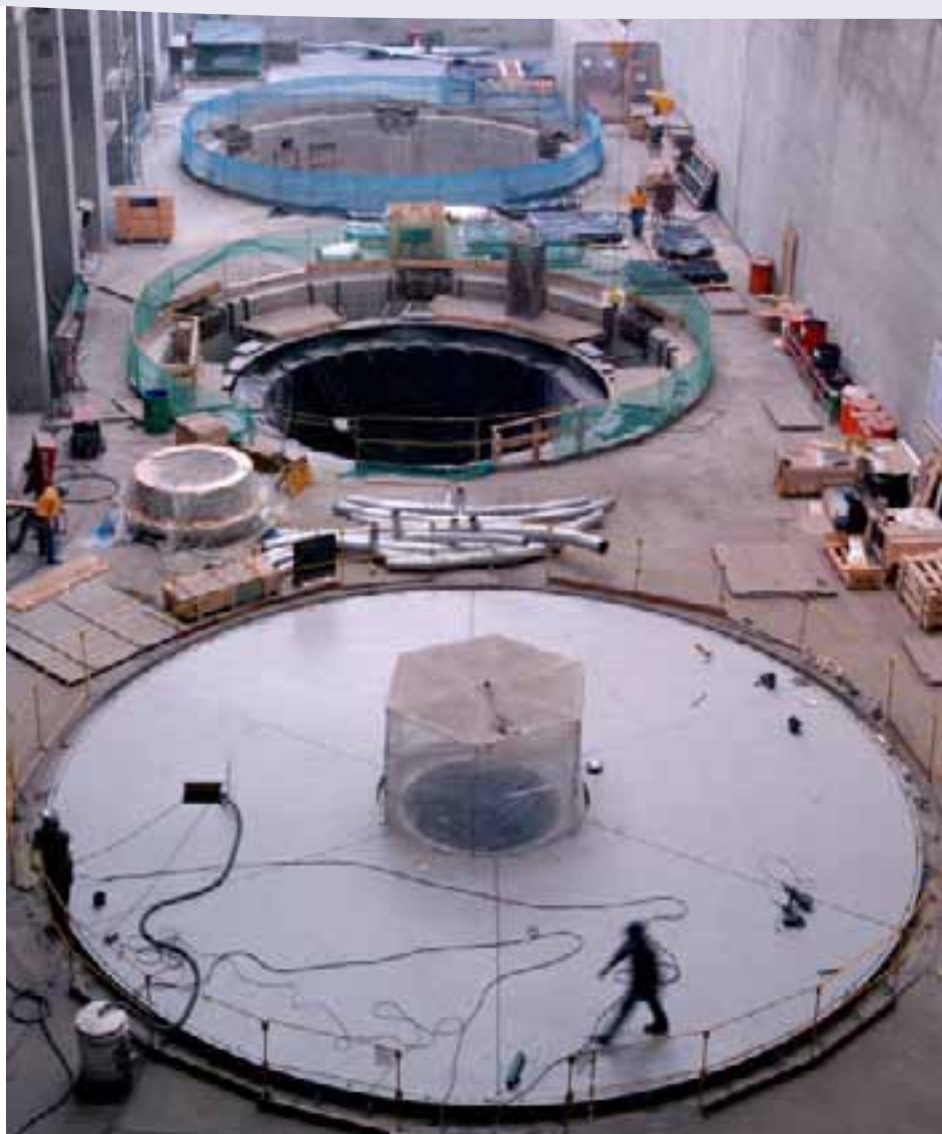
Vista interna da Casa de Força | UHE Barra Grande | Santa Catarina e Rio Grande do Sul
