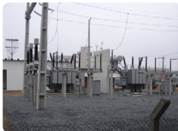
Subestação: 138 kV Potência Instalada: 50 MVA
