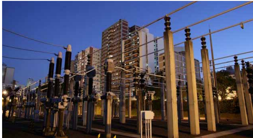
Subestação centro – Campinas/SP
