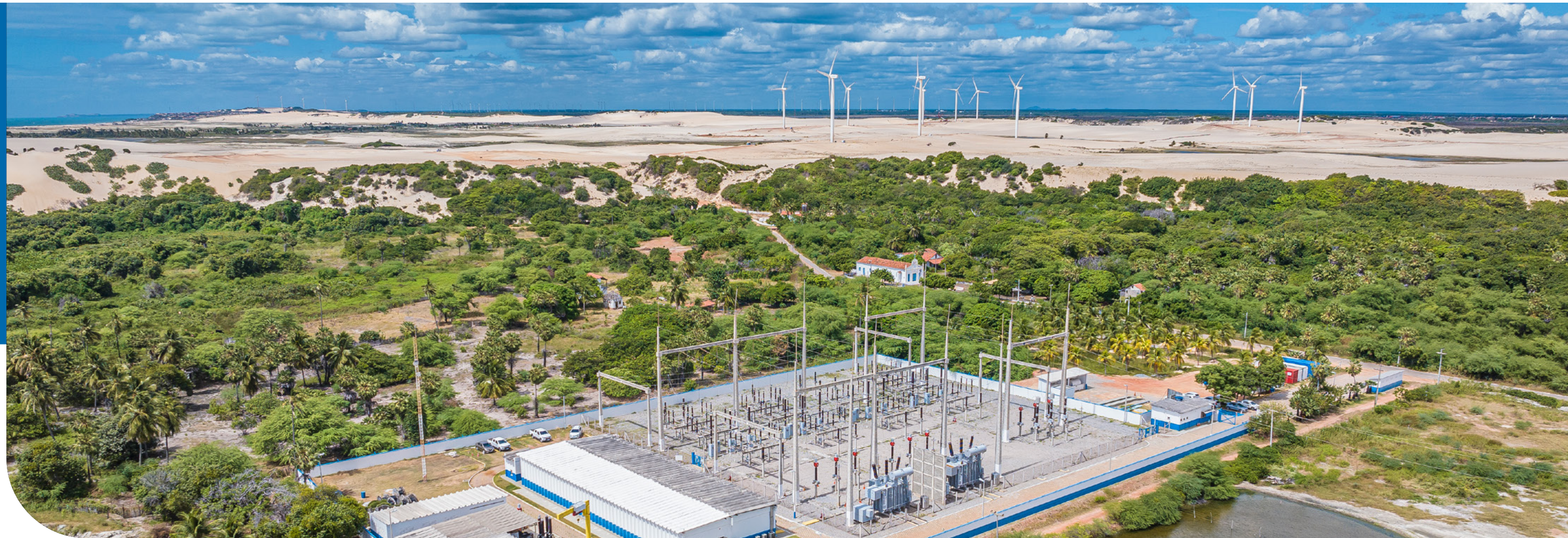
Complexo Eólico de Aracati, no Ceará.
