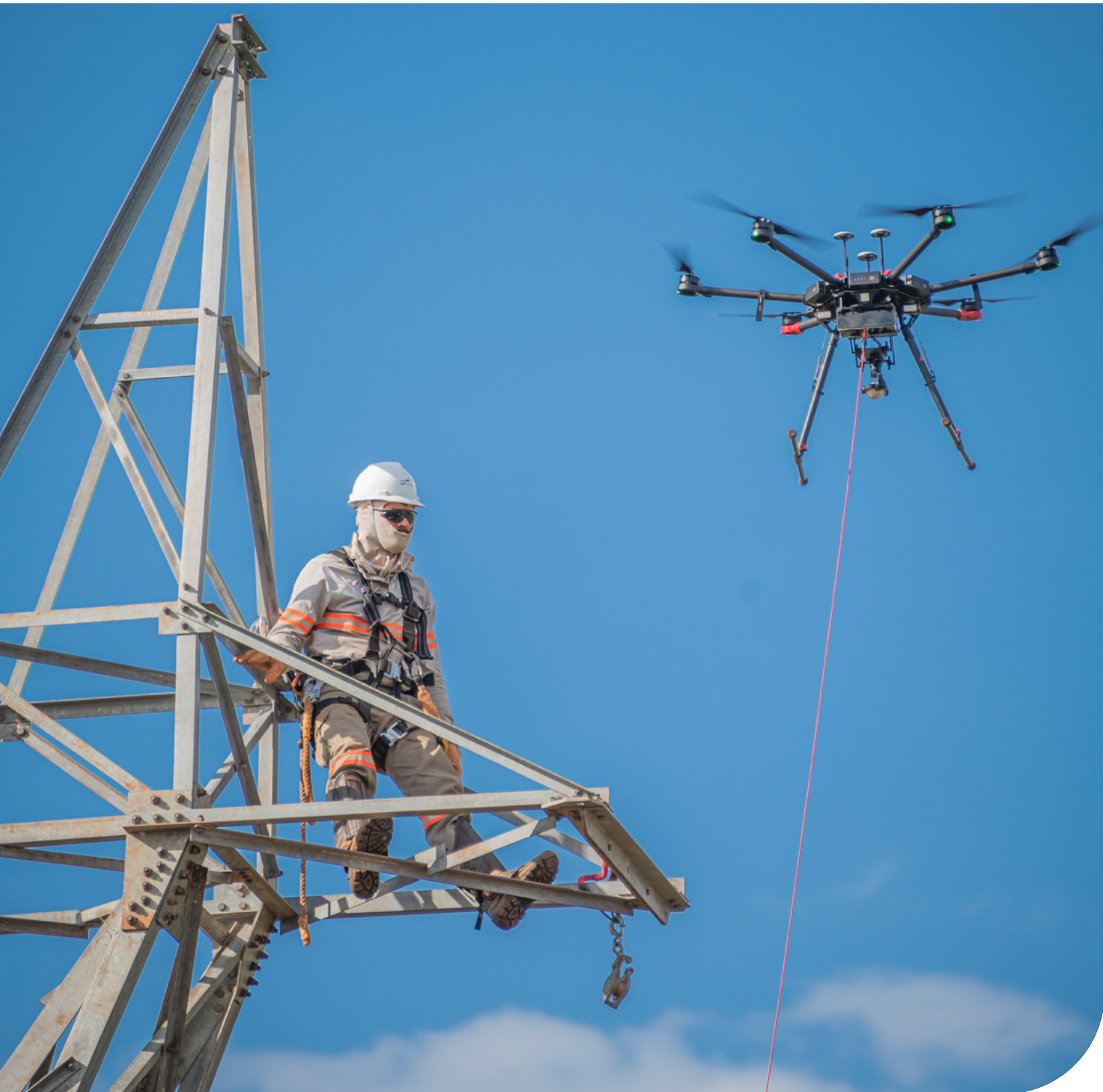
Operação da CPFL Soluções em Araraquara (SP).
