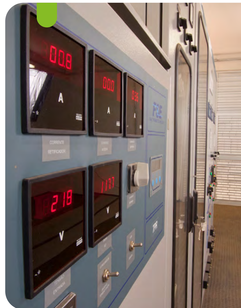
Usina de Biomassa
