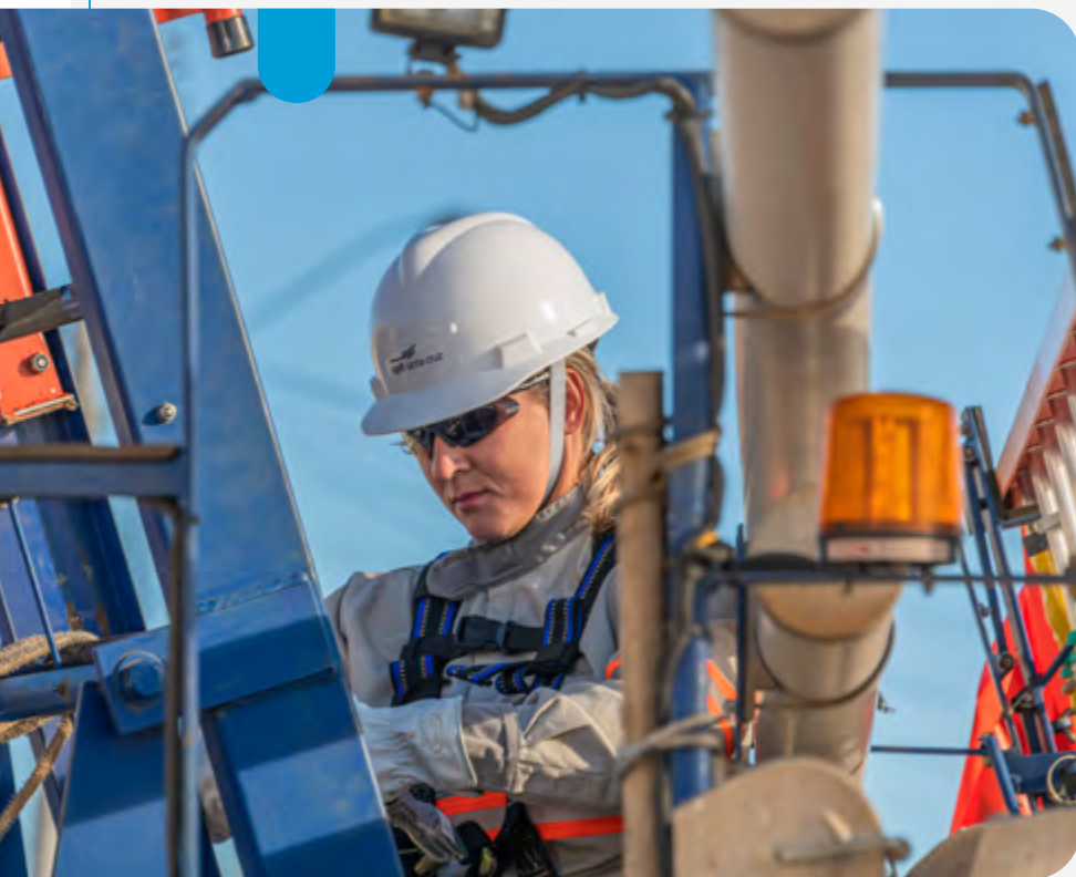
Colaboradora CPFL Energia
