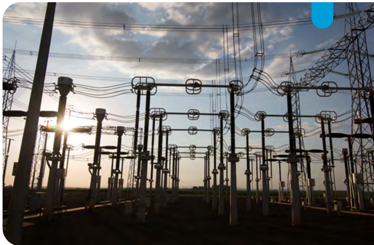
Subestação CPFL Transmissão Piracicaba
