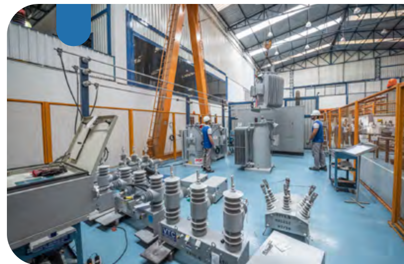
Reformadora de Equipamentos CPFL Energia
