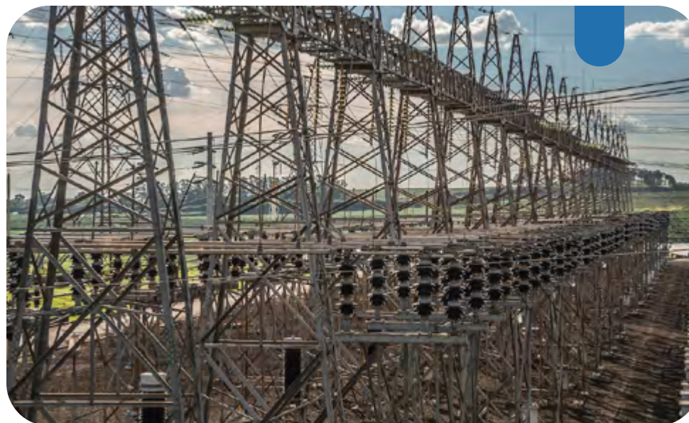
Subestação Tanquinho em Campinas - SP
