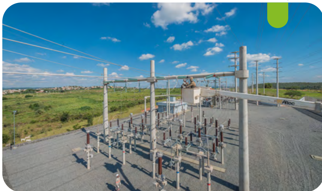
Subestação de energia
